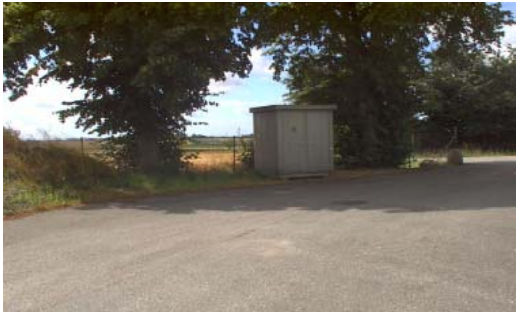
Figur 3.8 Eksempel på en skabsstation.
