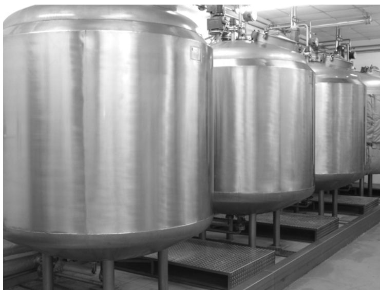
Figur 4.5 3000 L lukkede blandetanke med rørtåpningsanlæg til malinger baseret på organiske opløsningsmidler. Kilde: http://www.goindustry.com .
