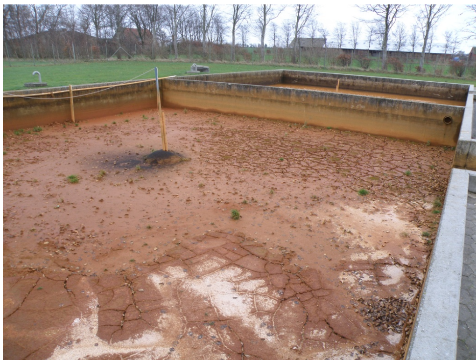
Figur 4-5 Slambede Astrup Vandværk, Esbjerg Forsyning.
