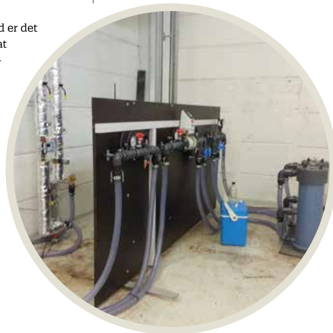
Recirkulationsanlæg og varmepumpe i forsøgsprojektet i Birkerød.
