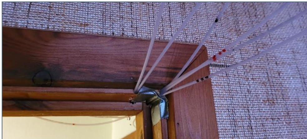
Figur 2.17. Gennemføring af prøvetagningsslanger via dørkarme og efterfølgende tætning med tape (endnu ikke gennemført fuldstændigt på dette eksempel).
