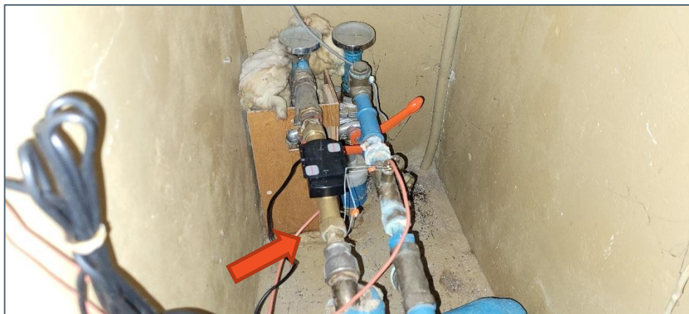
Figur 3.4. Bund af teknikskab set fra "adgangsvej" via trælåge i stue. Prøvetagningsplacering er markeret med rød pil.
