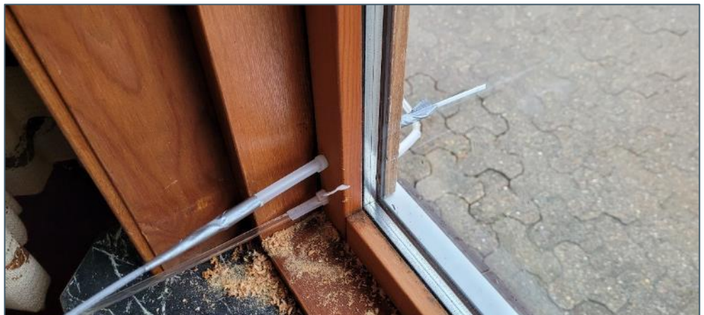
Figur 2.10. Gennemføring af afkastluft fra pumpe (nedre gennemføring) ført rundt om hushjørne. Øverst gennemføring af prøvetagningspunkt til blank-prøvetagning (udeluft).
