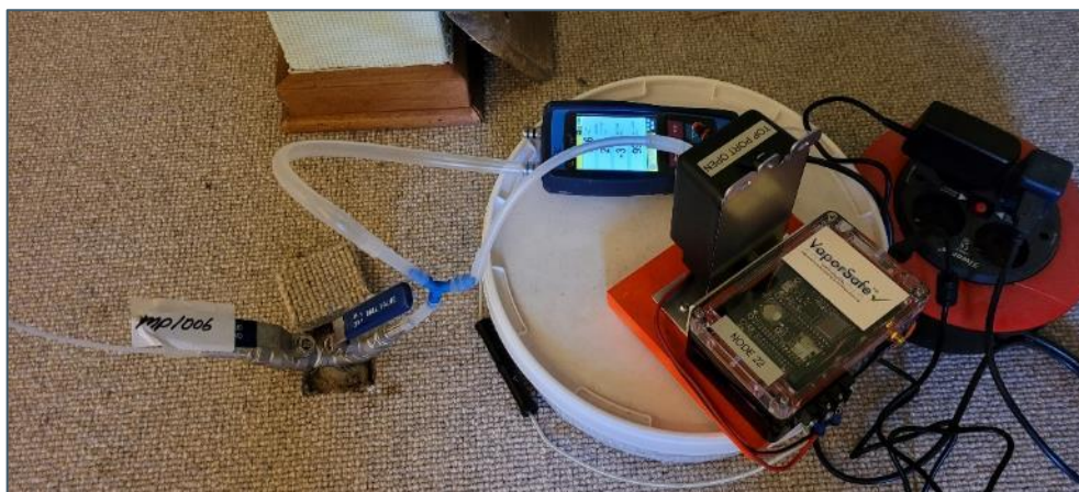
Figur 2.14. Monteret differenstryklogger (monteret på rød plade) på målepunkt gennem gulvkonstruktion. Via Y-stykke er der ligeledes monteret "traditionel" "offline" differenstryklogging.
