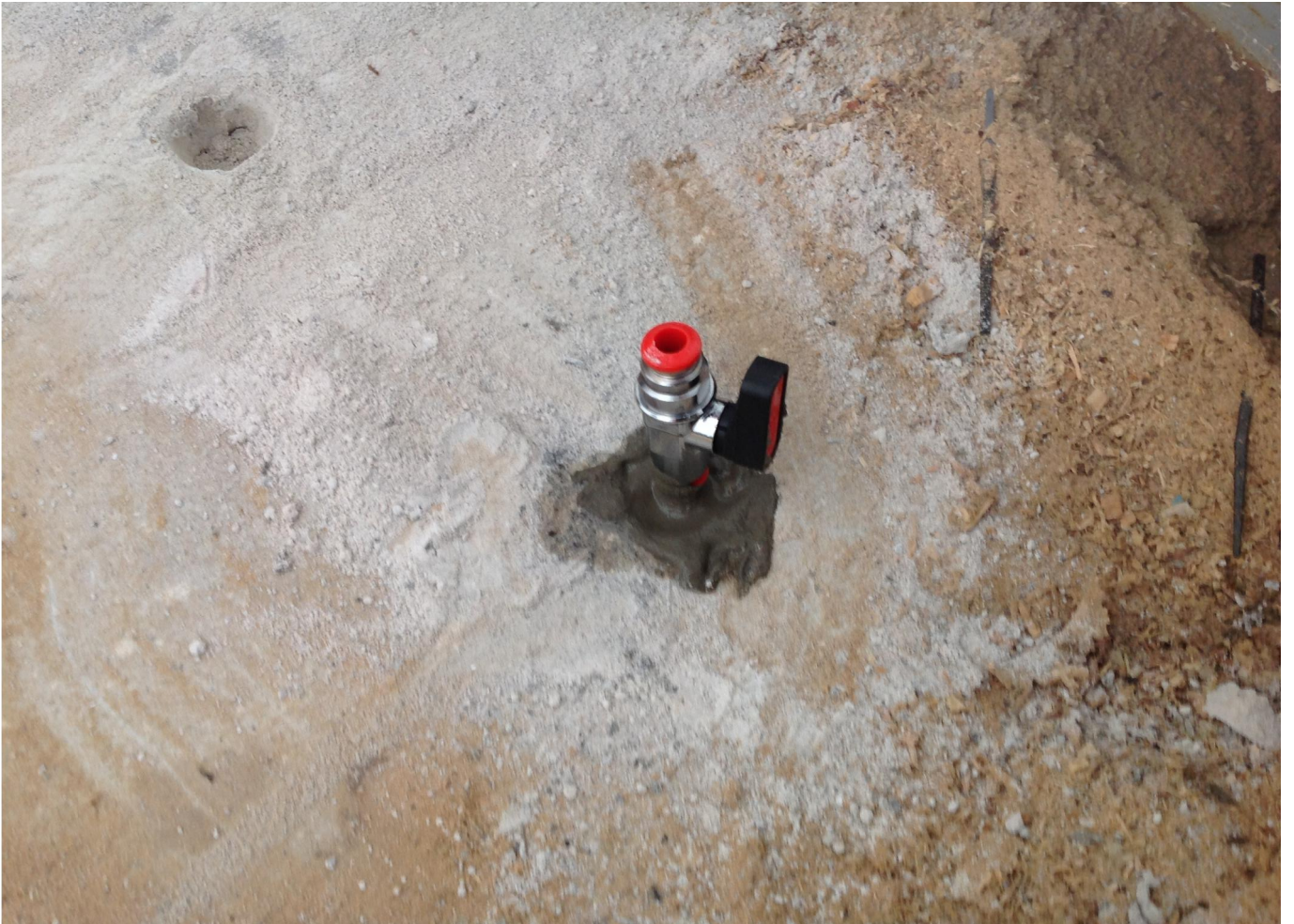
Installeret ventil til målepunkterne.
