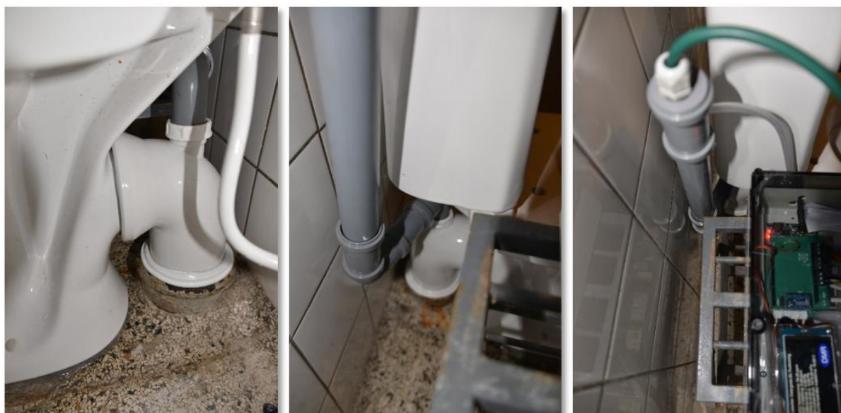
Figur 3.1 Fotos af bagsiden af prøvetagnings-WC i stueplan, inkl. installationsrør.
