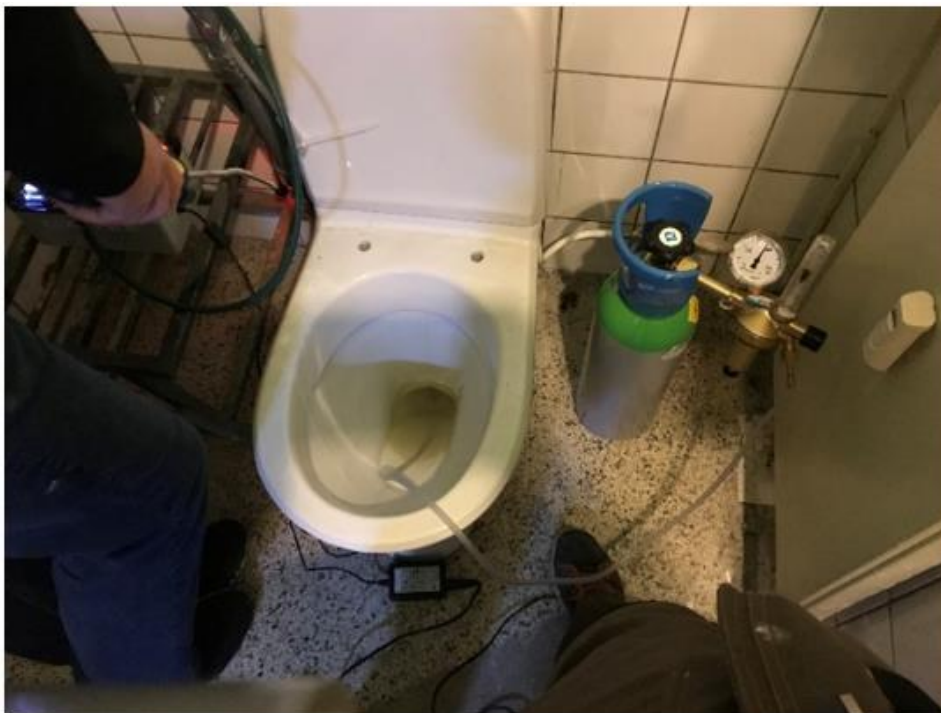
Figur 3.2 Sporgastest udført efter installation af prøvetagnings-WC i stueplan. WC'er inkl. installationsrør på bagsiden er konstateret tæt.
