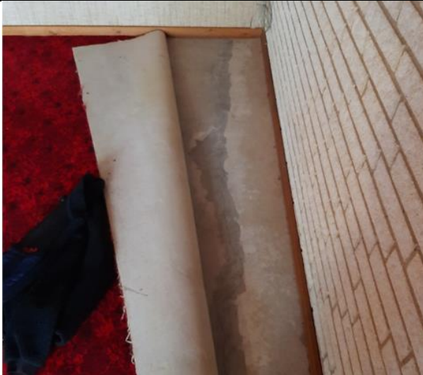
Foto 3: Til højre for MP1002, ses markant indtrængningsvej via revne i gulv (P1).
