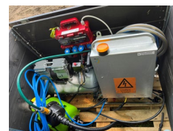
PileRem styring Styring til distribution af luft og væske til forsøgene. Til slam-forsøget tilføjes kun trykluft. Foto: K/S OilRem
