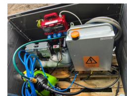
PileRem styring til automatisk injicering af trykluft og næringsberiget væske. Data sendes via LORA-WAN registreres i en database.
