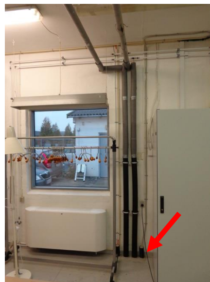
Billede 30: Vindue mod syd. Rørgennemføringer til varme og el.
