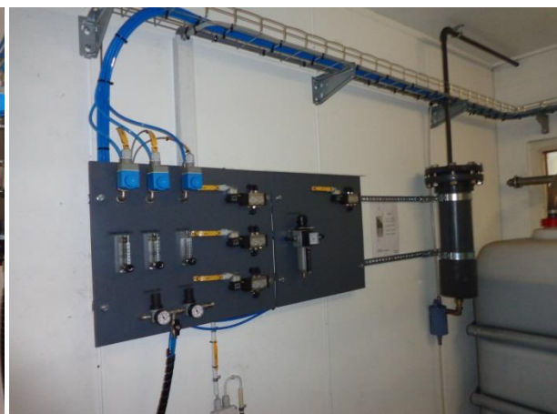
Billede 46: Kontroltavle til vandrenseanlæg.
