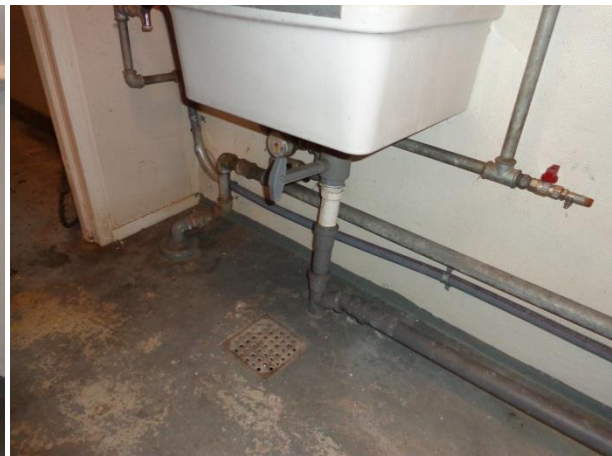
Billede 56: Gulv afløb og vandrør på WC i den vestlige ende af bygning I.
