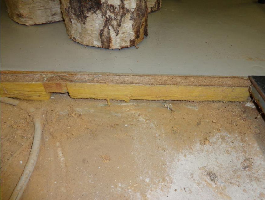
Figur 18: Trækonstruktion over beton, fra den tidligere østlige endegavl til første sæt teglsøjler (gulvtype 2). Fotovinkel er markeret i figur 17.
