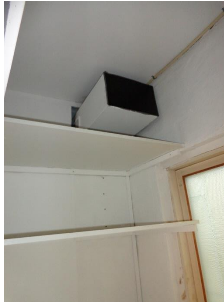
Billede 32: Ventilationskanal i lille rum på nordside af bygning I. Den anden side af kanalen ses på billede 41.
