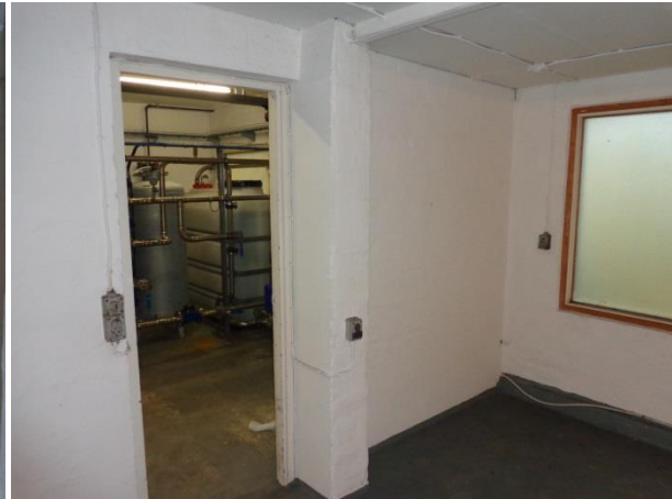
Billede 54: Dør til rum med vandrenseanlæg (fra sydrum i vestlig ende af bygning I).
