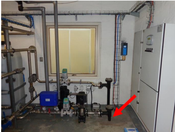
Billede 47: Rørgennemføringer til afværgeanlæg.
