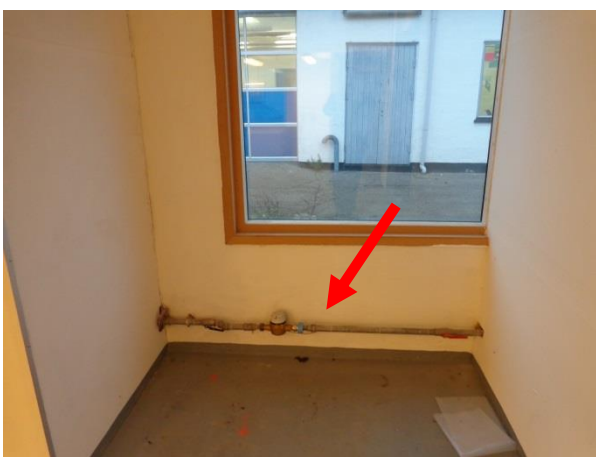
Billede 30: Vandrør og vindue på nordside af det centrale rum i bygning I.
