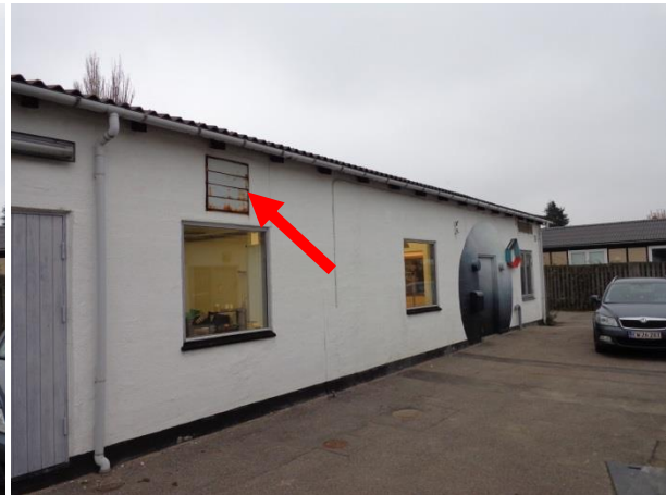
Billede 2: Sydside af bygning II. Ventilator.
