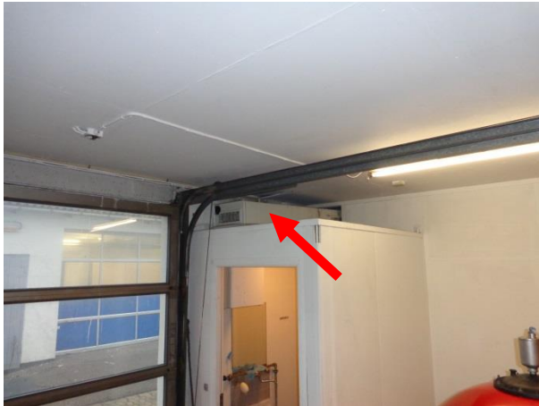
Billede 41: Ventilationsskanal imellem østlig og vestlig del af bygning I. Den anden side af kanalen ses på billede 32.
