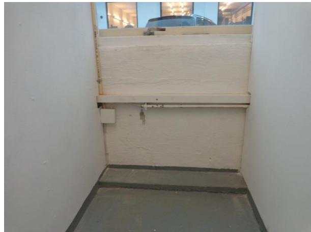
Billede 36: Elkabler ført på inderside af væg i lille rum på sydsiden af bygning I.
