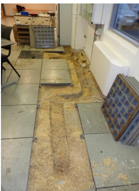
Billede 42: Bygning II, gennembrydning af gulvkonstruktion i sydside (mod øst).
