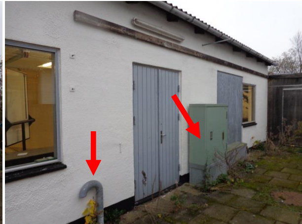
Billede 14: Nordside af bygning II. Svanehals og afværgeskab.
