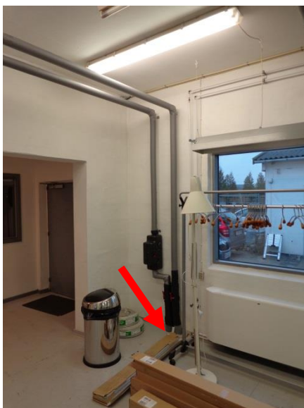
Billede 29: Vindue mod syd. Rørgennemføringer til varme.
