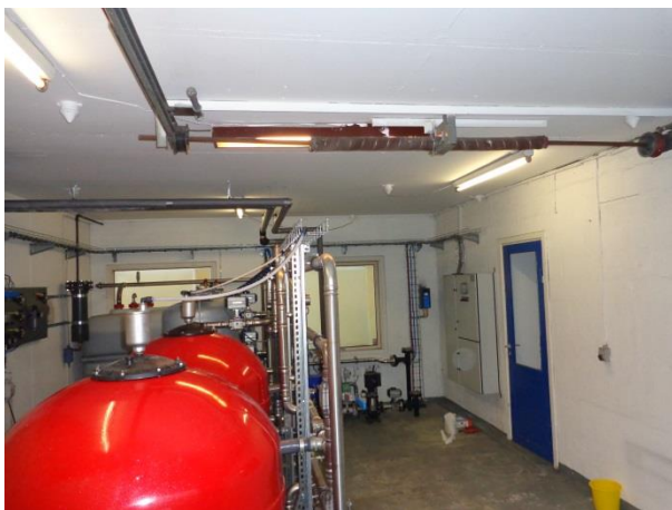
Billede 43: Vandrenseanlæg og dør til sydligt rum i den vestlige ende af bygning I.
