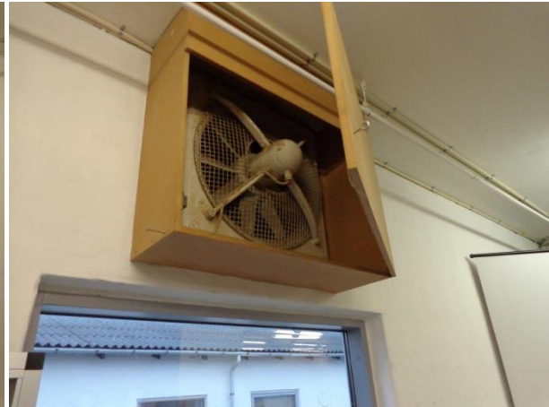
Billede 32: Ventilator i aflukket kasse over sydvendt vindue.
