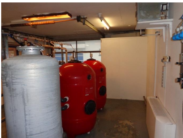
Billede 45: Vandrenseanlæg og WC i den vestlige ende af bygning I.
