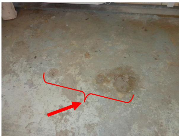
Billede 27: Huller fra tidligere pilotanlæg. Oplyst lukket december 2014.
