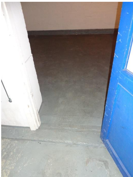
Billede 51: Dørtrin og niveauforskel (~7 cm) til sydtrum i vestlig ende af bygning I.
