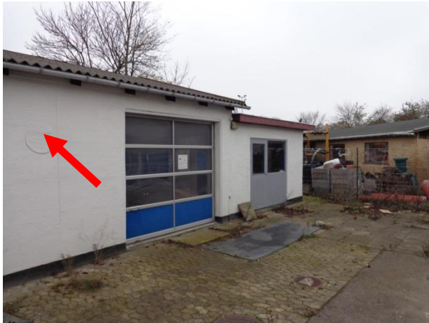
Billede 13: Nordside af bygning I. Afblændet ventilator.
