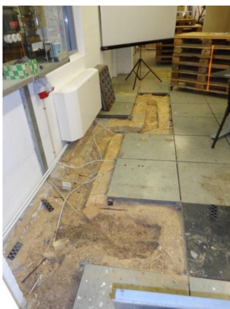
Billede 41: Bygning II, gennembrydning af gulvkonstruktion i sydside (mod vest).
