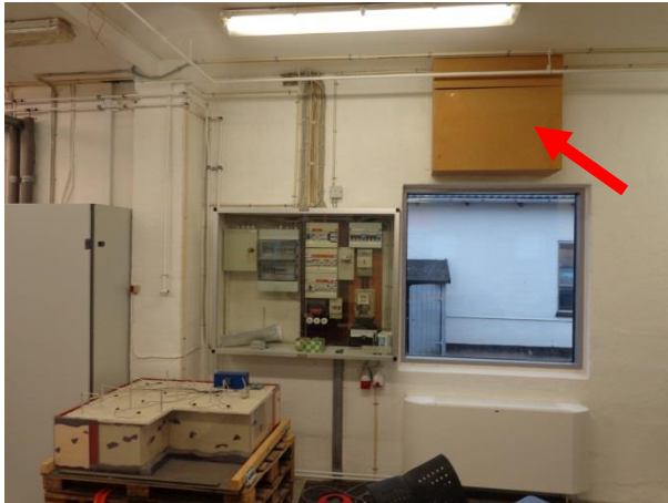
Billede 31: Ventilator i aflukket kasse over sydvendt vindue.
