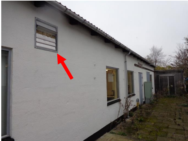
Billede 13: Nordside af bygning II. Ventilation.
