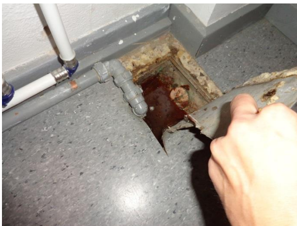
Billede 21: Kondensafløb i køkkengulv.
