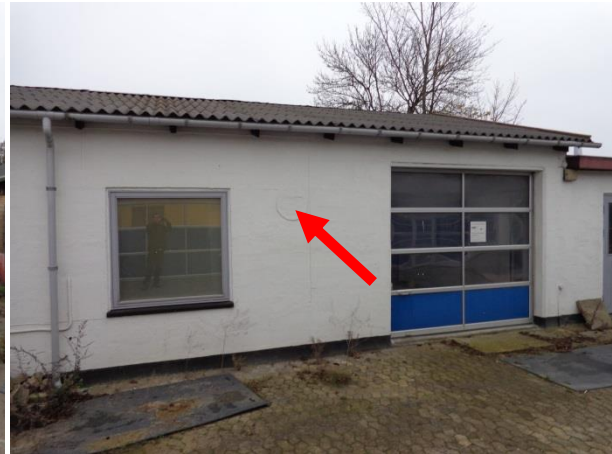
Billede 14: Nordside af bygning I. Afblændet ventilator.
