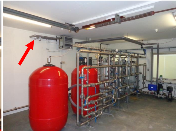
Billede 42: Vandrenseanlæg. Rørgennemføringer til centralt rum.
