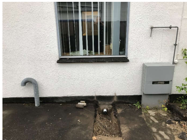
Billede 4: Ventilationsdræn u/køkken (øst).
