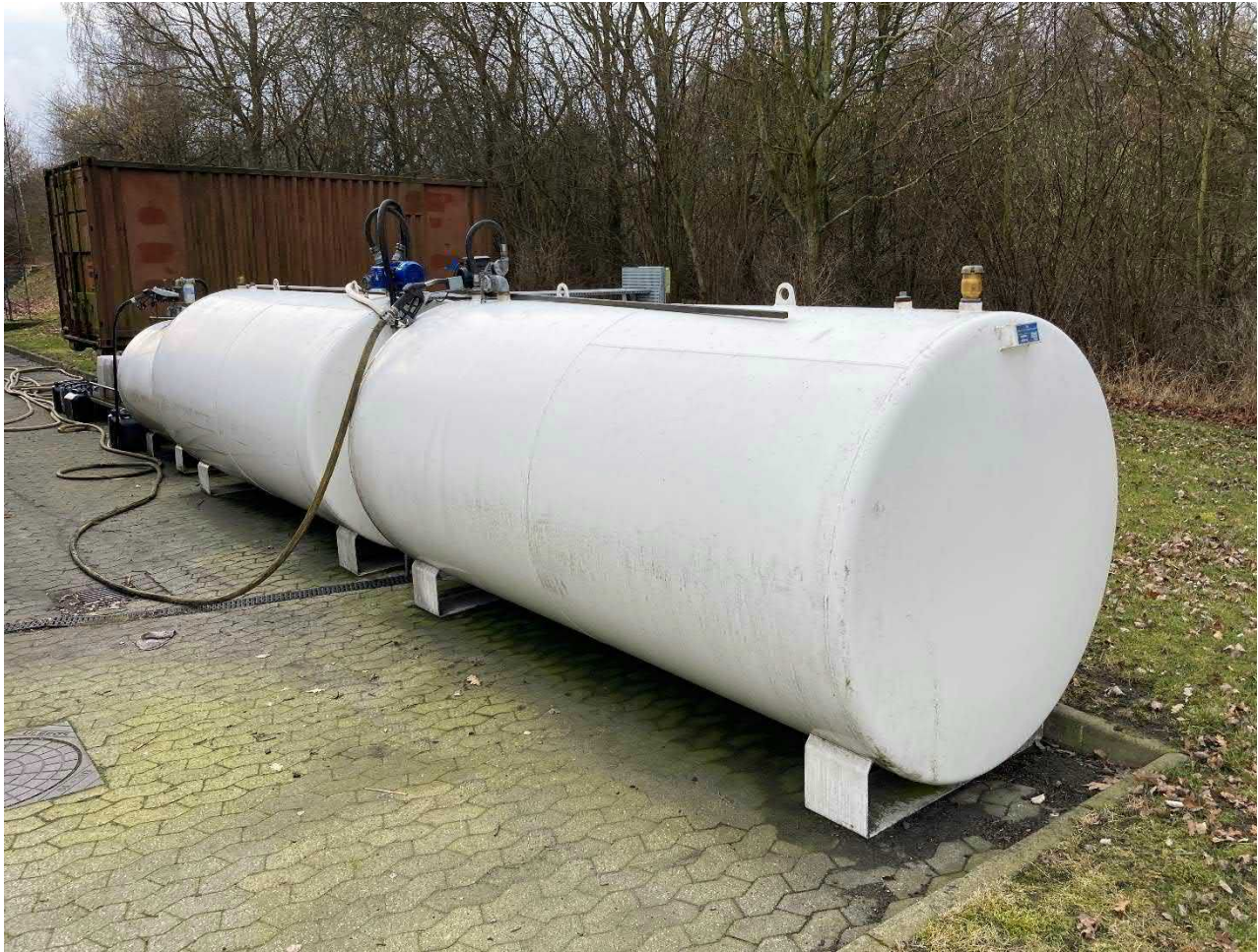
Foto 22. To 5.900 l tanke med Exxol (T6, T7) og en 1.500 l tank med Heptan (T8) (bruges til at tænde op med).
