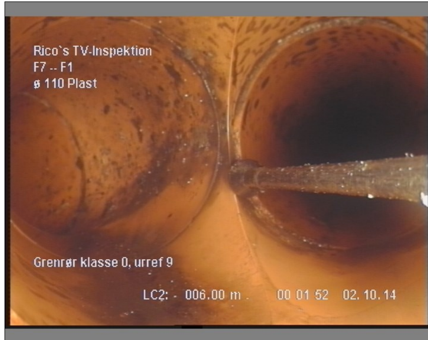
Foto: F7_F1_02-10-2014_084523_A.JPG, Medie #.: D14.04112, 00:01:53 6m, Grenrør klasse 0, urref 9
