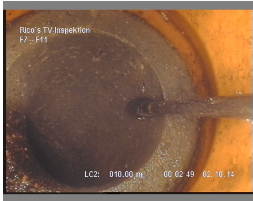
Foto: F7_F11_02-10-2014_091337_A.JPG, Medie #: D14.04112, 00:02:50 10m, Konstruktionsændring klasse 3, Dimensionsændring, Materialeændring
