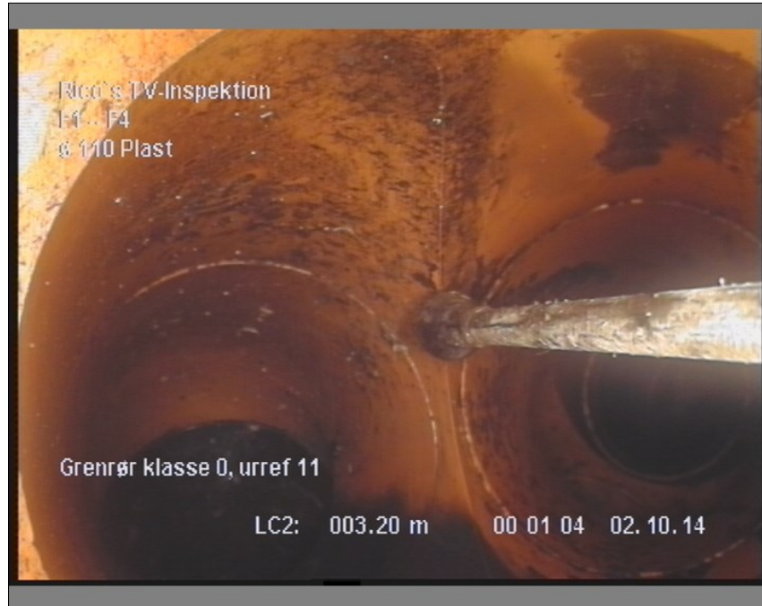
Foto: F1_F4_02-10-2014_081651_A.JPG, Medie #: D14.04112, 00:01:04 3,2m, Grenrør klasse 0, urref 11
