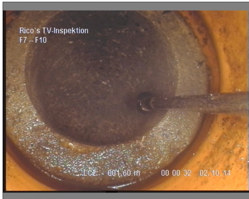
Foto: F7_F10_02-10-2014_090553_A.JPG, Medie #: D14.04112, 00:00:33 1,6m, Konstruktionsændring klasse 3, Dimensionsændring, Materialeændring
