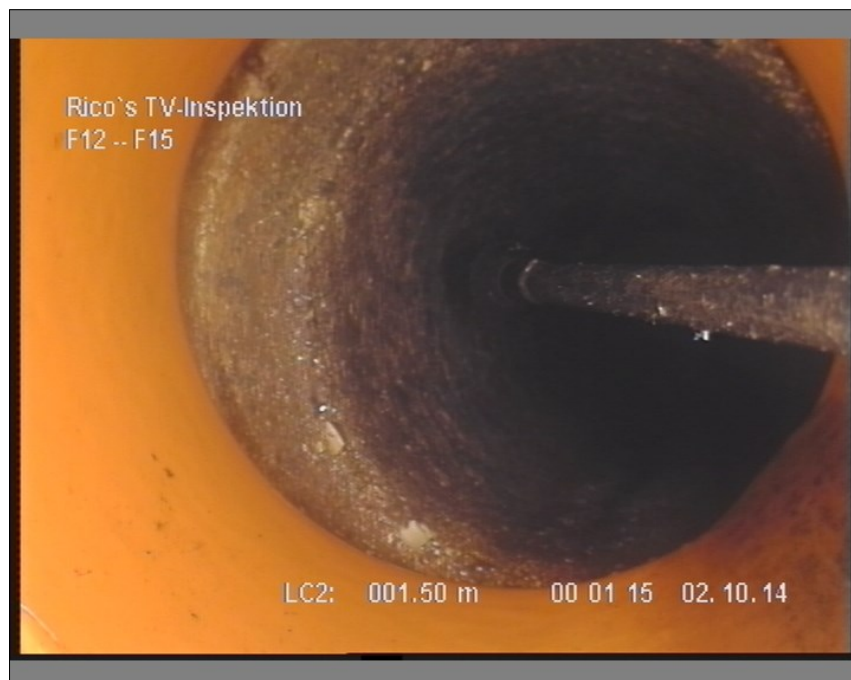
Foto: F15_F12_02-10-2014_101107_A.JPG, Medie #:: D14.04112, 00:01:15 1,5m, Konstruktionsændring klasse 3, Dimensionsændring, Materialeændring
