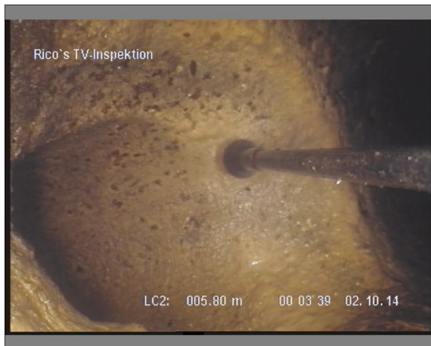
Foto: F15_F12_02-10-2014_101428_A.JPG, Medie #:: D14.04112, 00:03:40 5,8m, Grenrør klasse 0, urref 10
