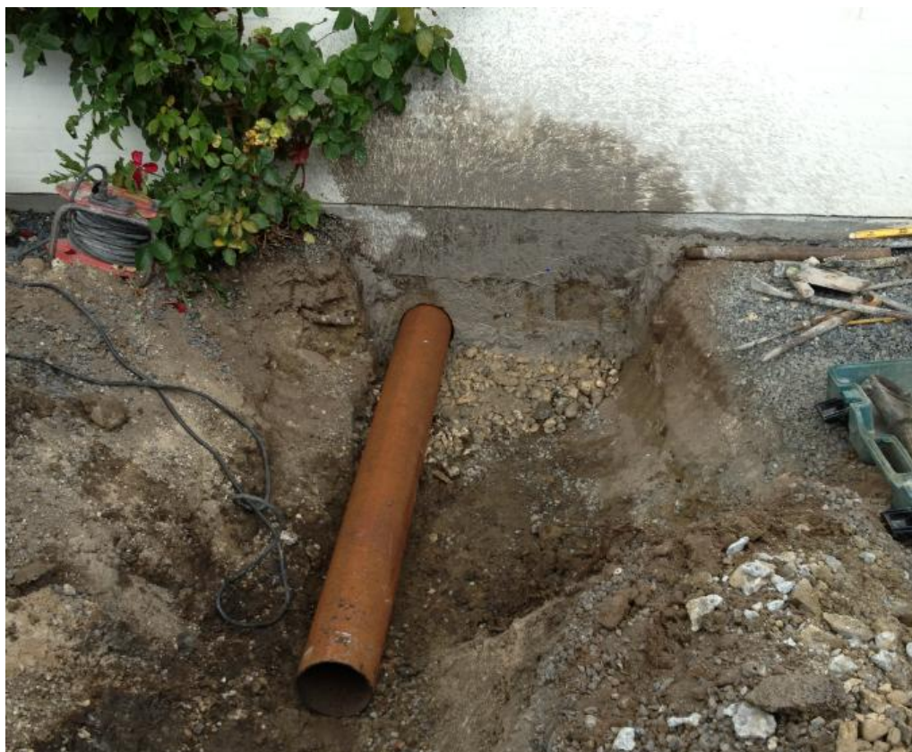
Figur 5: Ventilationsdræn 3 er klar til at blive udført, umiddelbart efter skæring af hul i fundament.
