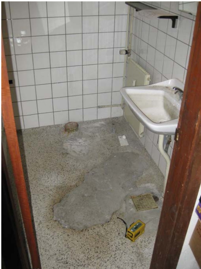
Foto 1: Billede af WC1. Toiletet er afmonteret.
